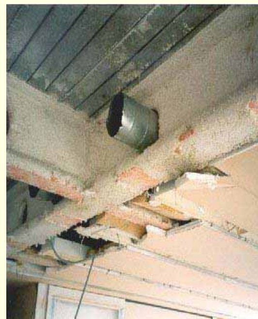
Amiante floqué sur structure métallique
