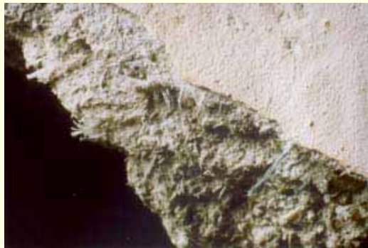
Plaque de fibrociment utilisée pour l'isolation thermique
