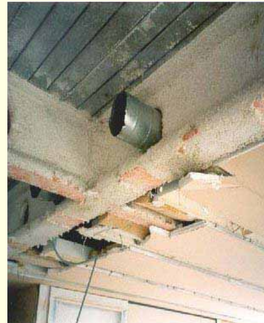
Spritzasbest an einer metallischen Tragkonstruktion
