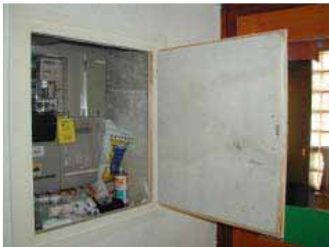
Lastra antincendio contenente amianto nel vano fusibili
