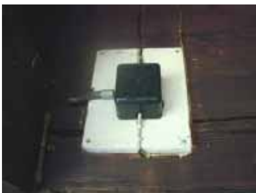
Scatola telefonica applicata su un pannello in cartone di amianto
