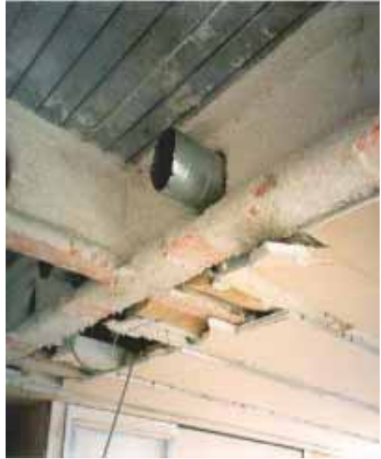
Amiante floqué sur structure métallique
