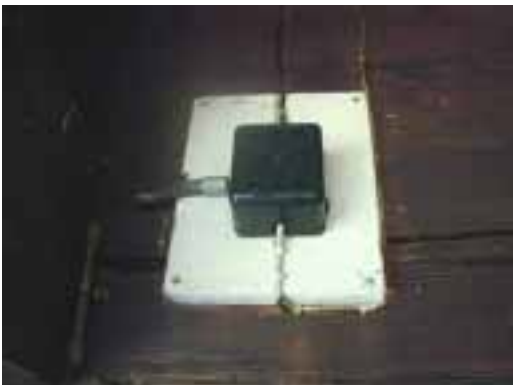
Carton d'amiante derrière un boîtier téléphonique
