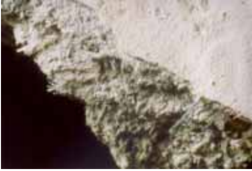
Bruchstelle einer Asbestzementplatte zur Wärmedämmung
