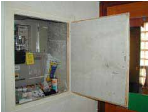
Asbesthaltige Brandschutzplatte im Sicherungskasten
