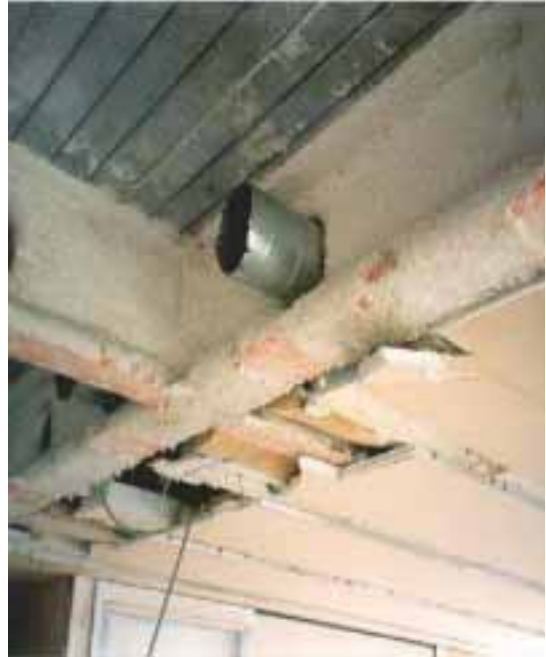
Spritzasbest an einer metallischen Tragkonstruktion
